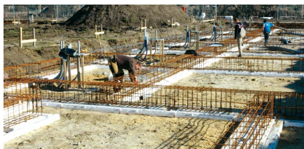
4 Wapening plaatsen en afstandhouders aanbrengen die voldoende betondekking geven en geschikt zijn voor isolatie op zachte ondergrond.
